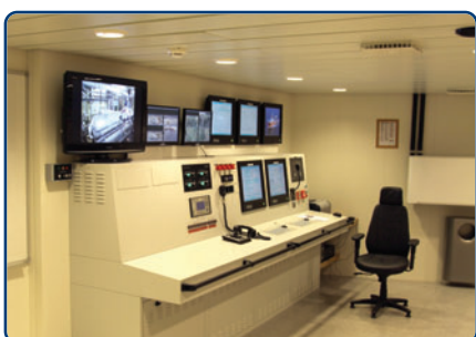
Centrala manewrowo-kontrolna (CMK).
