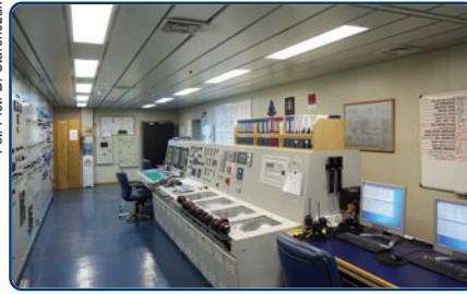
Centrala Manewrowo-Kontrolna (CMK) w siłowni.
