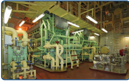
Siłownia - jedno z dwóch pomieszczeń zespołów prądowców.
