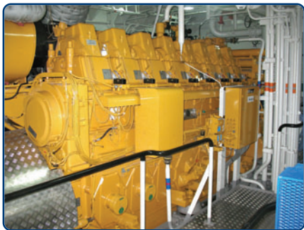
Jeden z silników napędu głównego.
