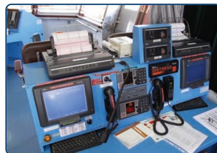
Stanowisko GMDSS i łączności satelitarnej.
