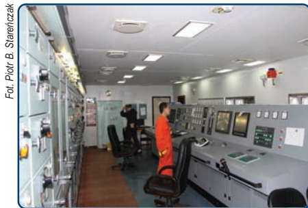
Centrala manewrowo-kontrolna siłowni.
